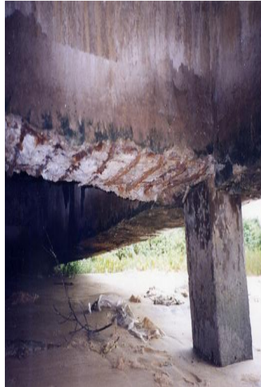
Рисунок 4 – Коррозия бетона в прибрежных районах
